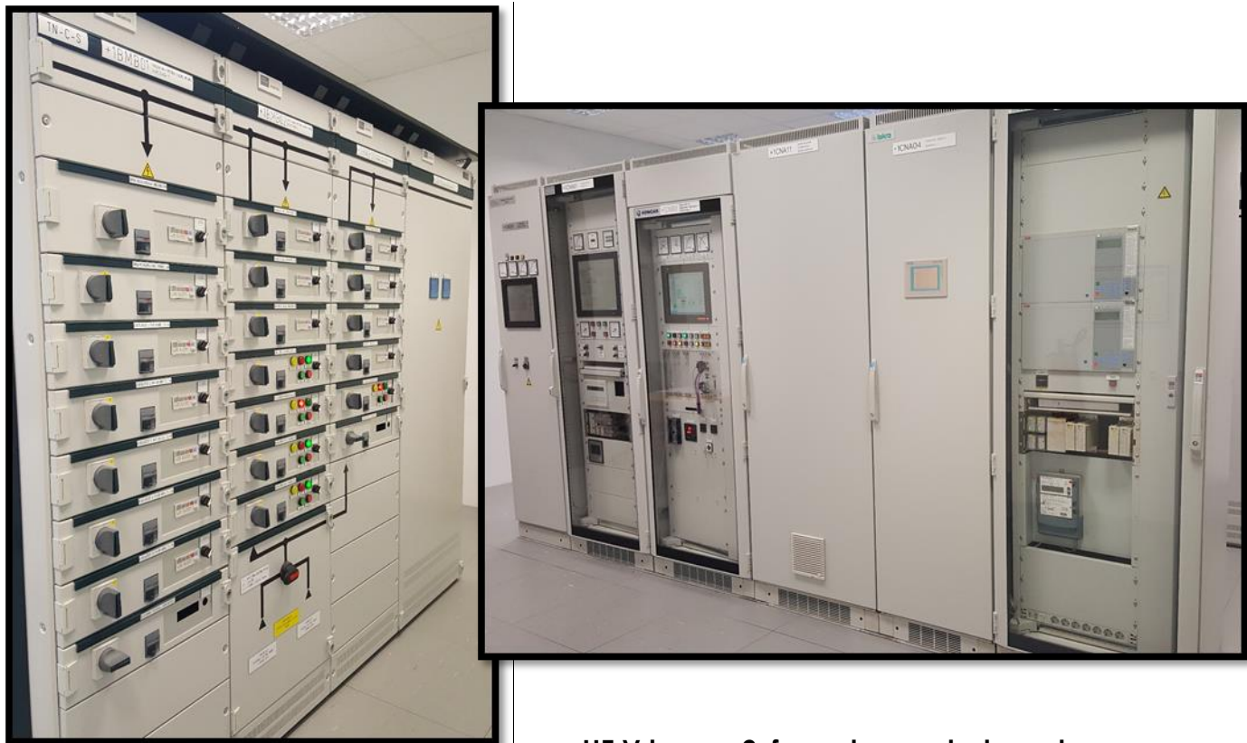
HE Vrhovo – 2. faza obnove, lastna raba, omare vodenja vzbujanja in zaščite
