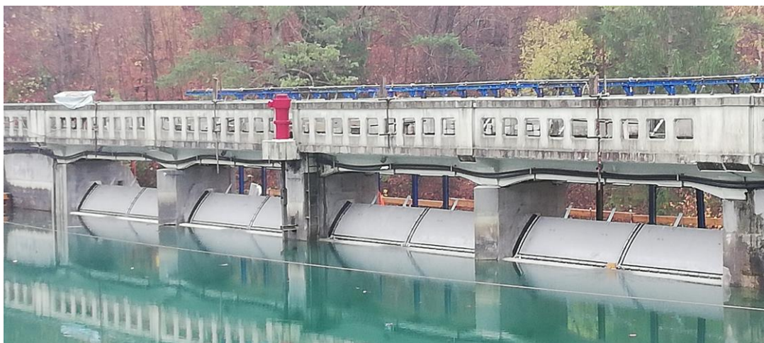
HE Završnica – zapornice na pregradi
