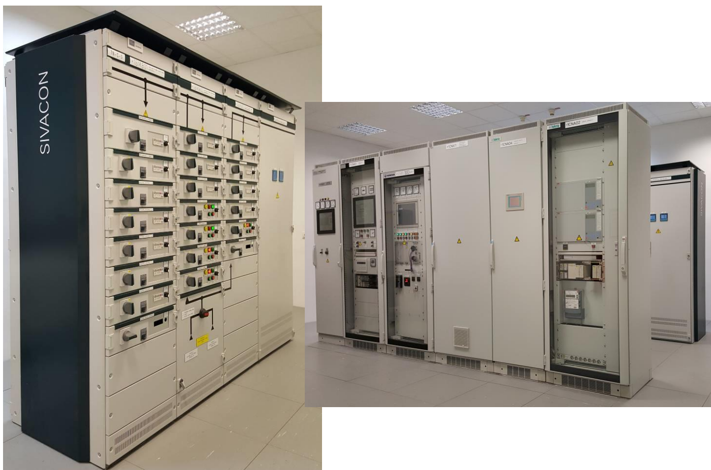
Obnovljene omare sistema vodenja, vzburjanja in tehnološke lastne porabe HE Vrhovno
