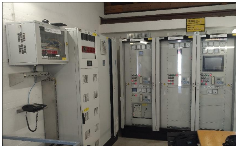
Nova elektro oprema elektrarne
